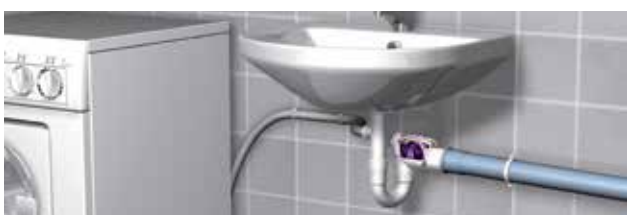
Lavatórios com sifões e ligação para máquina de lavar
